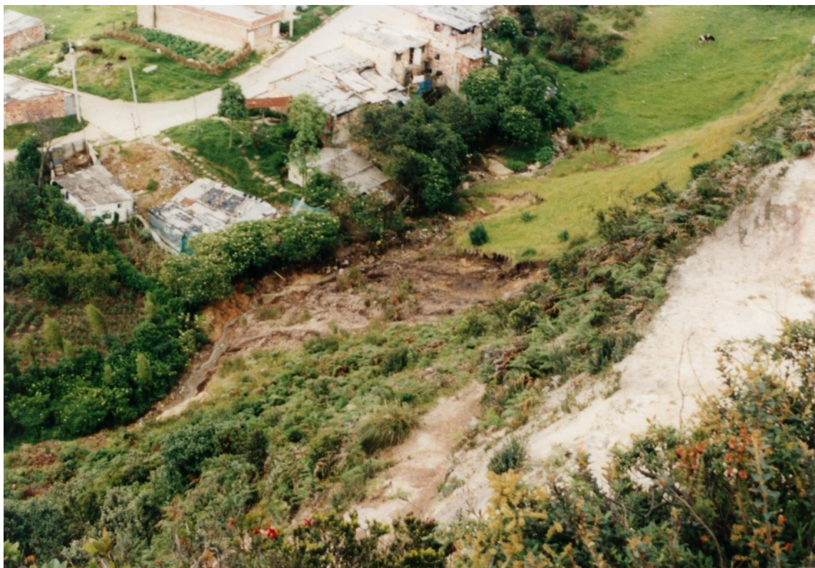
Photo 26 : Glissement de terrain provenant de la colline de Juan Rey. En haut à gauche, on peut voir des maisons du quartier La Belleza. En-dessous de la ligne d'arbres se trouve le ruisseau La ' Nutria. (DAMA 2000)
