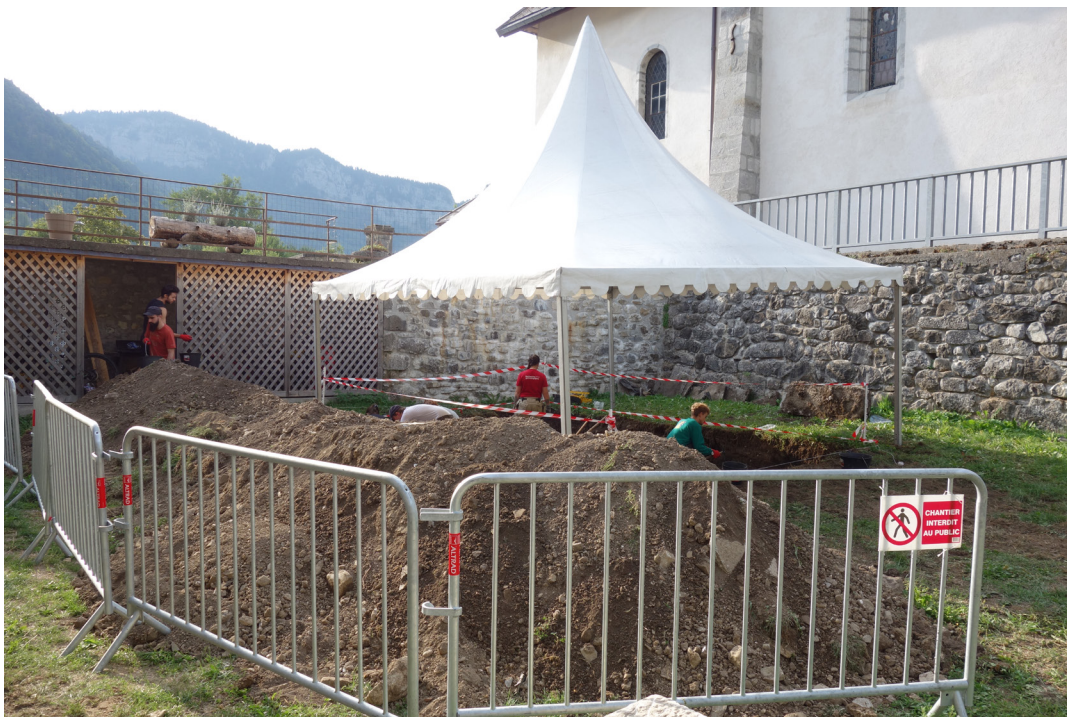
Fig. 17 - Sécurisation du chantier par des barrières et panneau «Chantier interdit au public».
