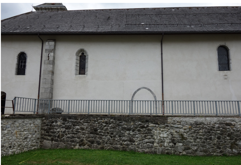
Fig. 11 - Mur de soutènement de la parcelle de l'église (n° 17).
