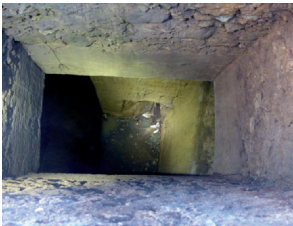
Figure 10 : la chambre de captage de la galerie moderne dite «galerie des Romains». cl. R. Haurillon.
