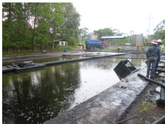
Figura 1. Balsa de acumulación de crudo.
